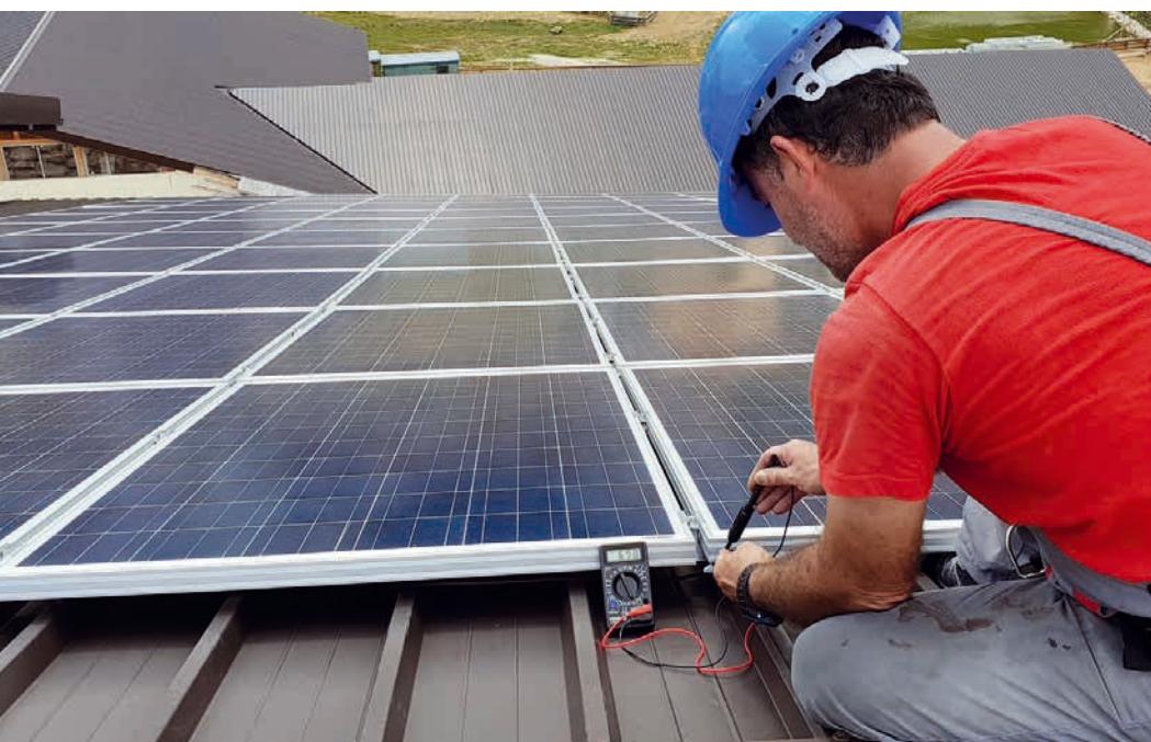
Dachflächen können für Photovoltaik genutzt werden.
